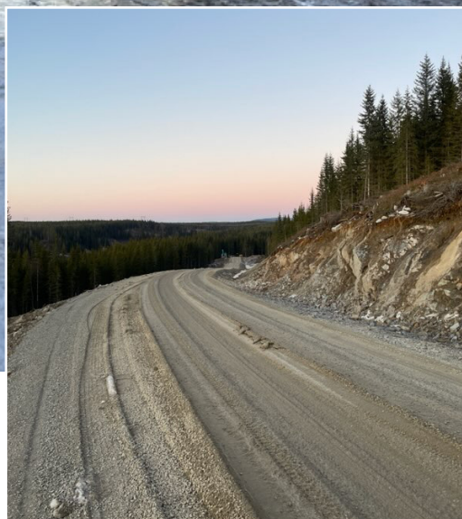
Bygging av Kluksætervegen november 2024. Her er bærelag og slitelag påkjørt. Høvling og pussing av grøfting blir gjort etter vegen har tørket opp sommer 2025.
