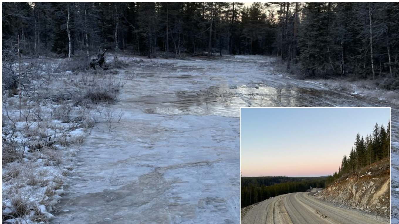
Opparbeiding av vinterbilveg ved Nysætra høst 2024. Vinterbilveg gir mulighet til å hente tømmer ute i terrenget uten terrenginngrep.
